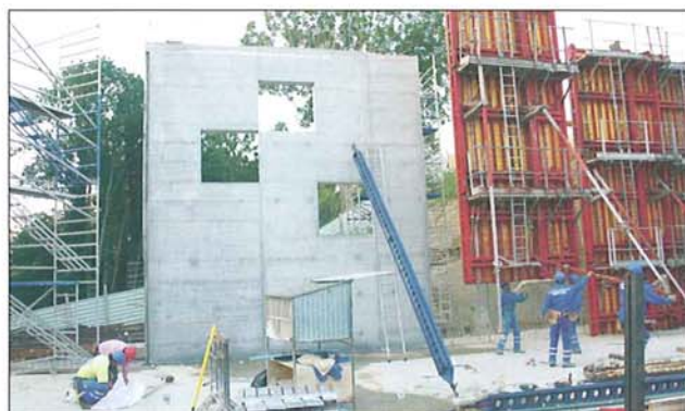
Mise en place des coffrages (octobre 2005). Les façades porteuses ont une épaisseur de 25 cm (photo Holcim).
