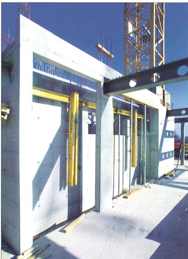
Coppet: la structure du bâtiment est constituée d'une charpente métallique supportant des dalles Holorib bétonnées avec du SSC, celui-ci garantissant un remplissage impeccable des zones entre nervures. Photo Pierre Boss
